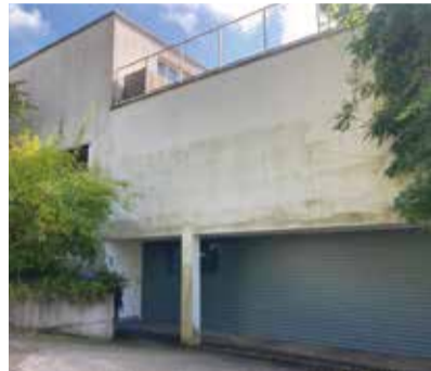
Putzfassade mit Grünalgenbefall.
