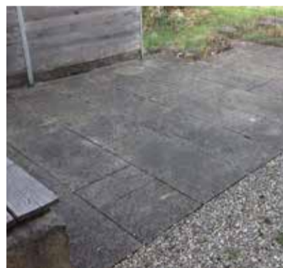
Sandsteinplatz mit Flechtenbefall.
