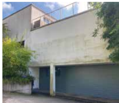
Putzfassade mit Grünalgenbefall.
