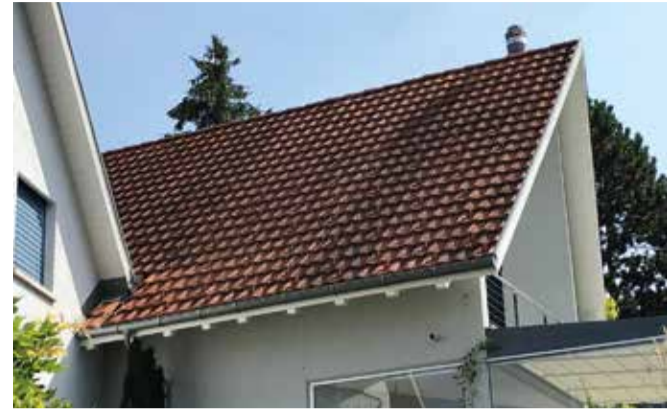
Tonziegeldach mit Algenbefall und Moos.
