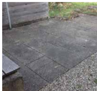
Sandsteinplatz mit Flechtenbefall.
