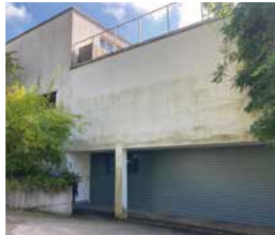
Putzfassade mit Grünalgenbefall.
