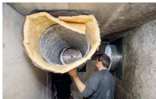
Der Anschluss nach draussen erfolgt über schalloptimierte Luftschläuche.
