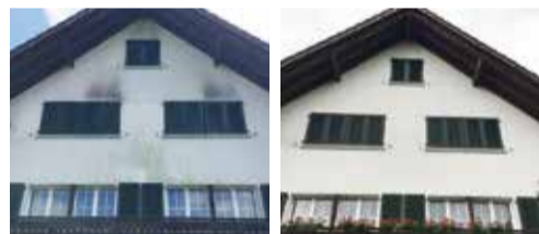
Putzfassade mit Grünalgenbefall.
