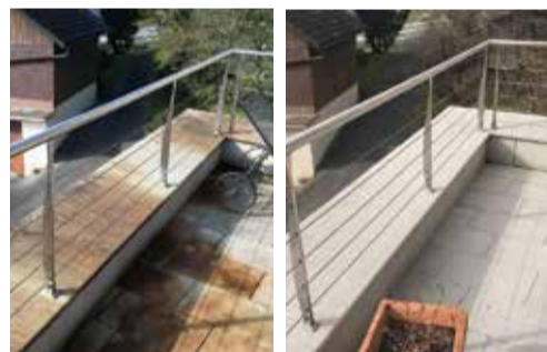
Sandsteinplatz mit Flechtenbefall.
