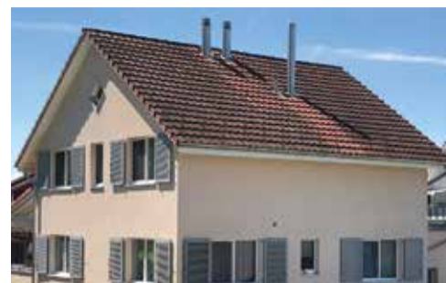
Tonziegeldach mit Schwarzalgenbefall.
